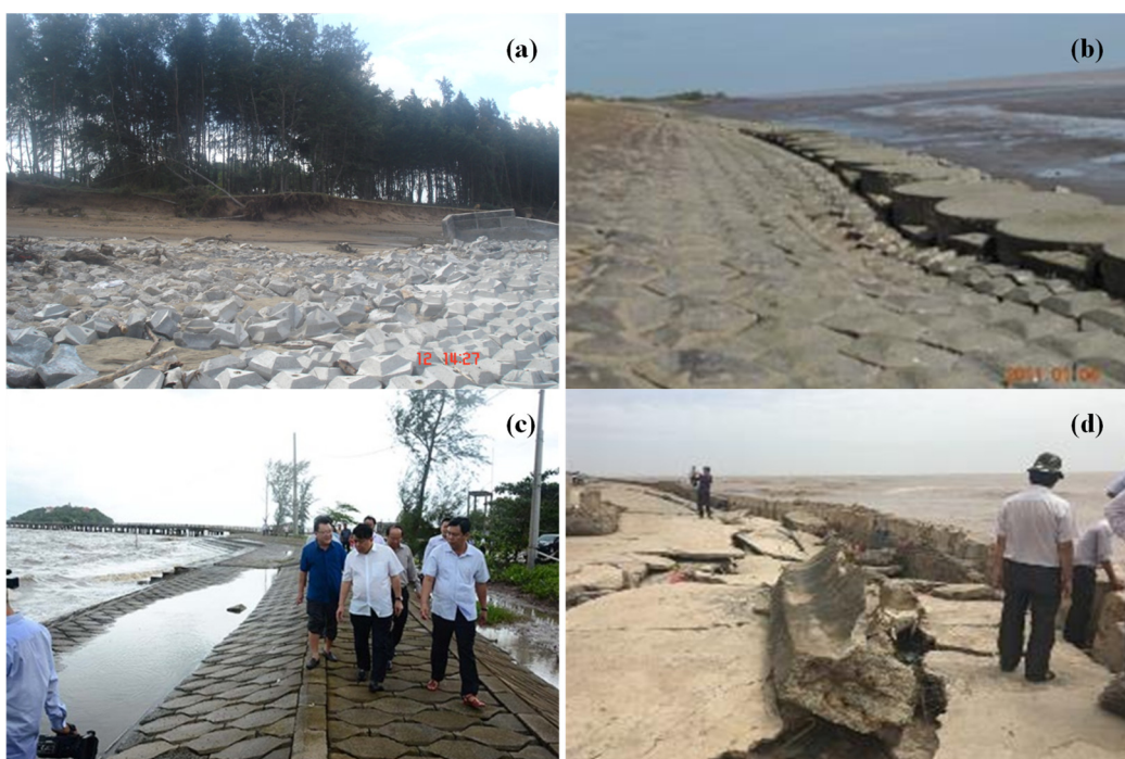
Hình 11. Điển hình công trình kè biển bị hư hỏng do chuyển vị nền móng yếu: (a) Trà Vinh; (b) Tiền Giang; (c) Cà Mau; (d) Bạc Liêu.
