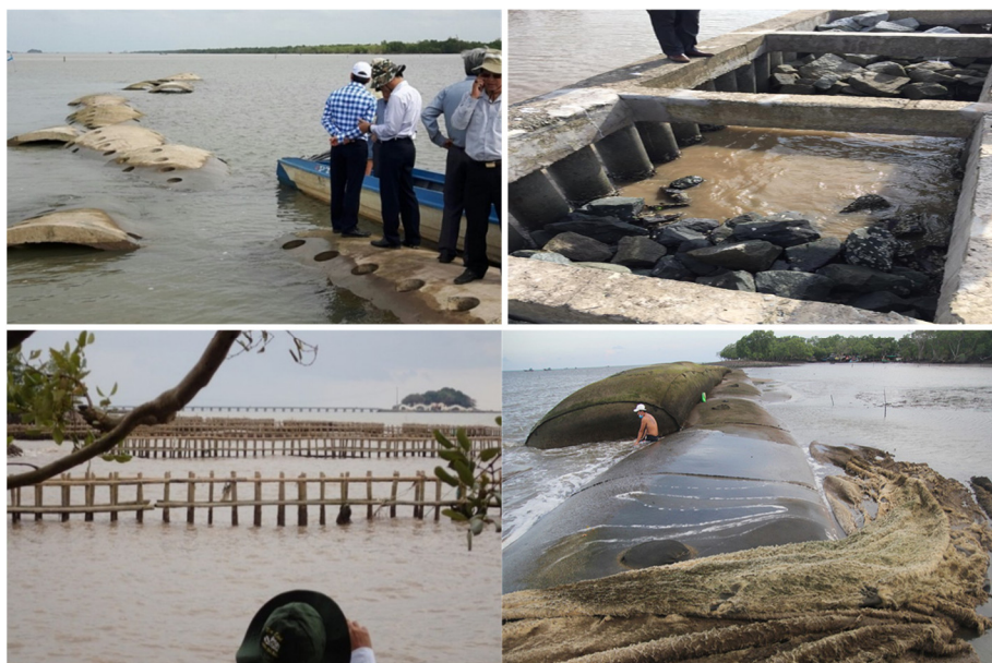
Hình 19. Các kết cấu mới bị hư hỏng trong giai đoạn thử nghiệm.
