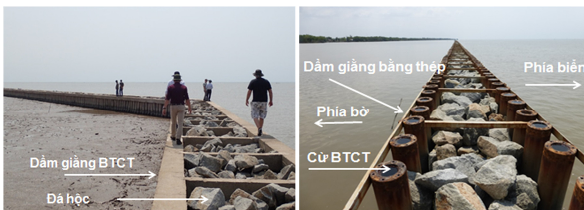
Hình 15. Kết cấu điển hình của đê phá sóng dạng cọc bê tông ly tâm đá đổ.
